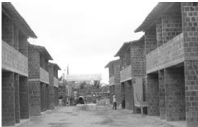
Ampliar o estoque de moradias e gerar uma redução progressiva do déficit , atendendo ao segmento de mais baixa renda
